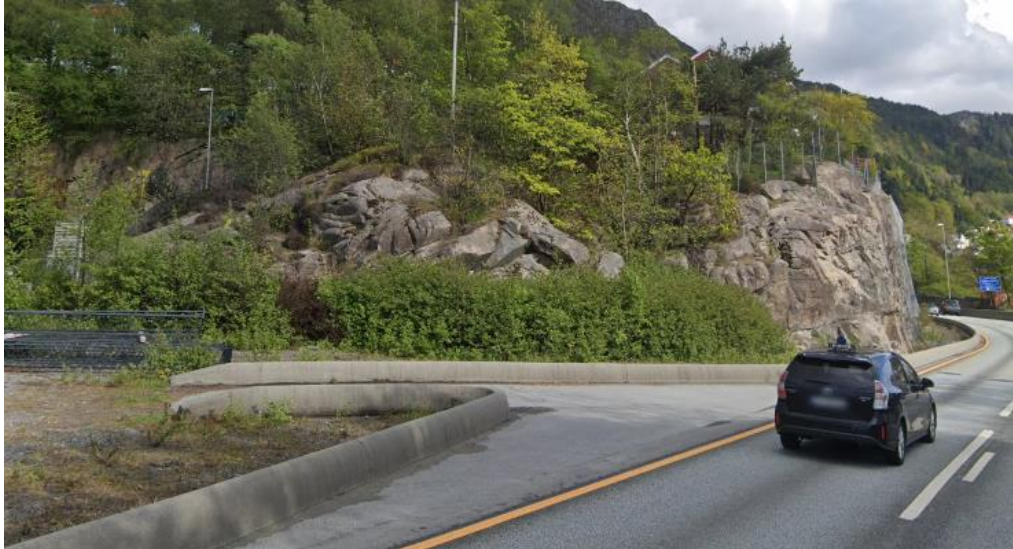
Figur 4-8: Foto av bergmassen i påhuggsområdet ved Sandviken sykehus. Forskjæringen skal etableres inn i berghammeren på bildet. Taket på Munkebotn 16 er synlig bakerst i bildet.
